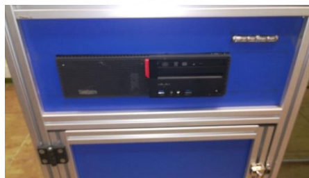
Fig. 2 Unidad de almacenamiento y procesamiento de datos
